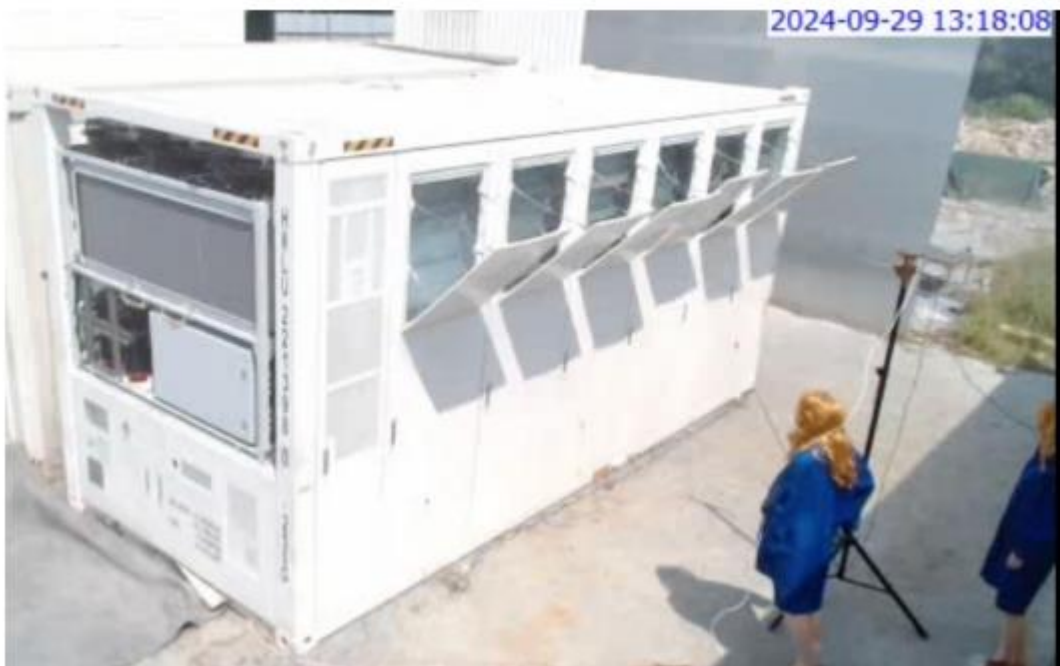
Figur 3-4. Trykaflastning udført i paneler over dørene. Billedet er taget fra eksplosionstest, vedlagt i Bilag A.
