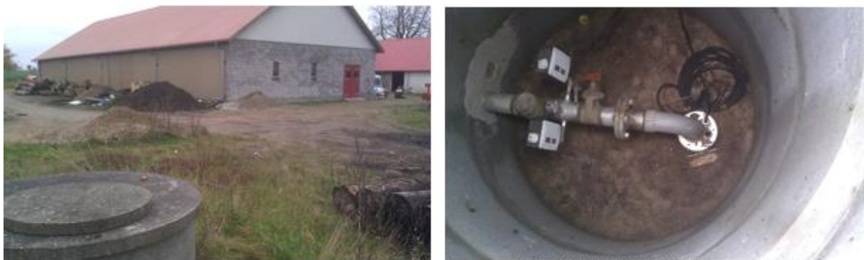
Figur 2 - Indvindingsanlægget. Anlægget består af en tørbrønd og boring DGU nr. 142.743 med tilhørende elinstallation m.m. – billeder fra COWI registreringsblad 2012.
