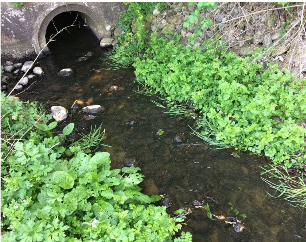
Figur 7. Stryg ved indløb i vejbroen ved Hvidkærgårdsvej
