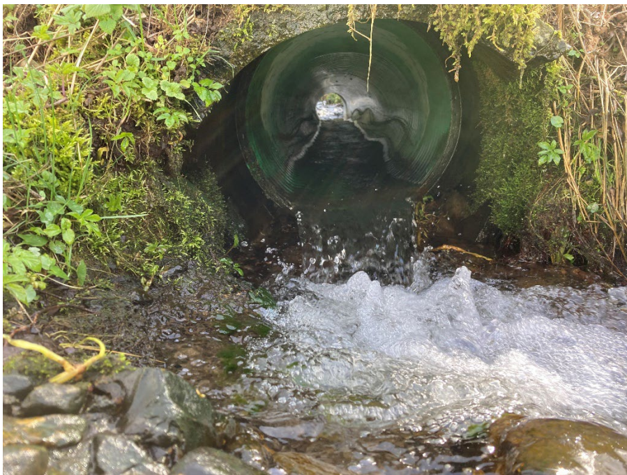
Figur 5. Fald ved udløbet fra røroverkørslen
