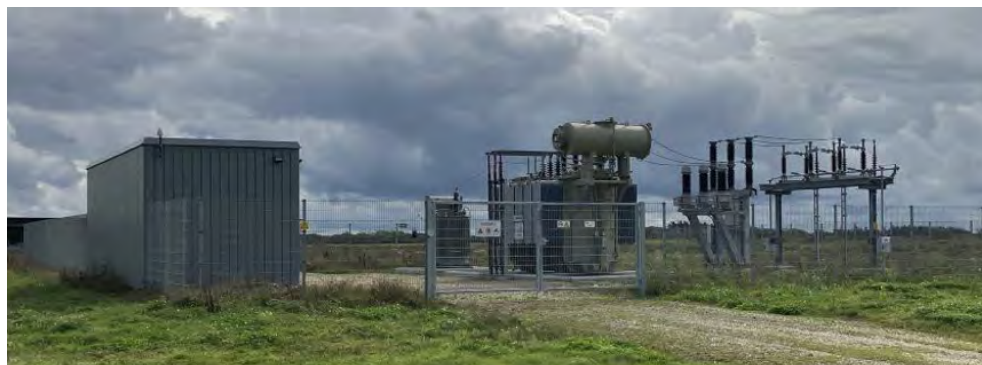
Figur 1-6 Eksempel på transformer og teknikbygning.
