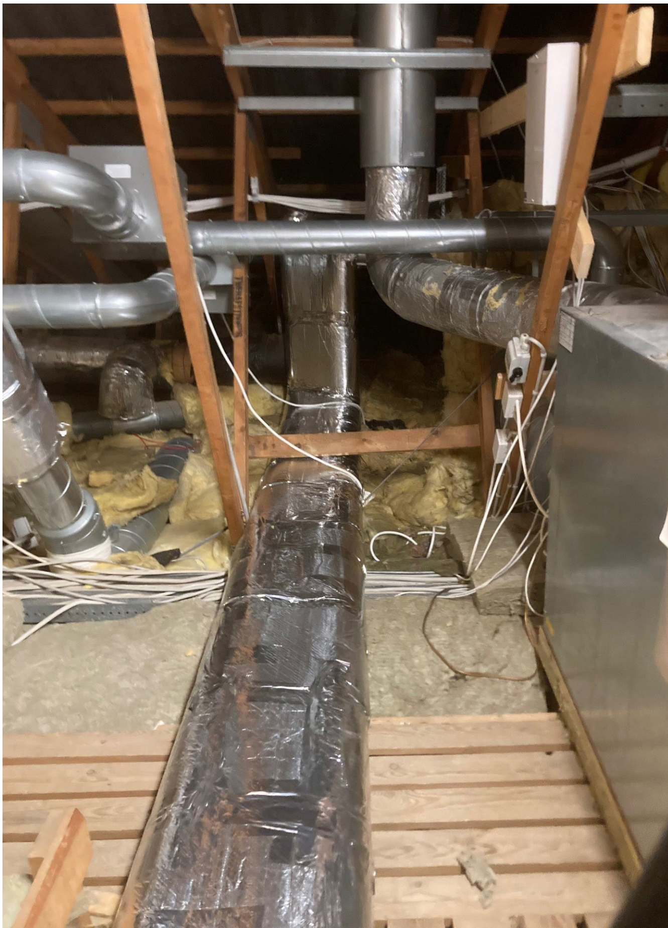
Isolering af ventilationskanaler, CSV
