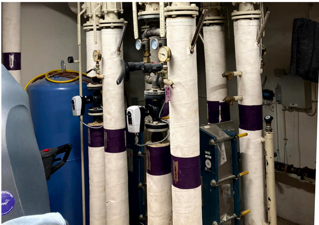
Øverst: Mange varmebesparelser er opnået ved brug af AI genererede varmeanalyser og Servicesektionen Nederst: Varmeinstallation, Marielund - Døgncenter for Socialpsykiatri
